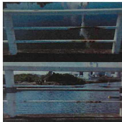
高欄手摺部が腐食・破損して危険なため応急処置を実施
