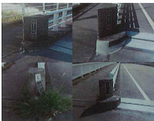
毘沙門橋地覆部コンクリート及び橋名板の補修を実施
